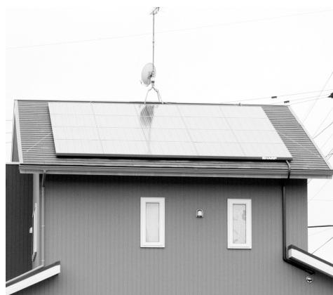
▲太陽光発電システム
