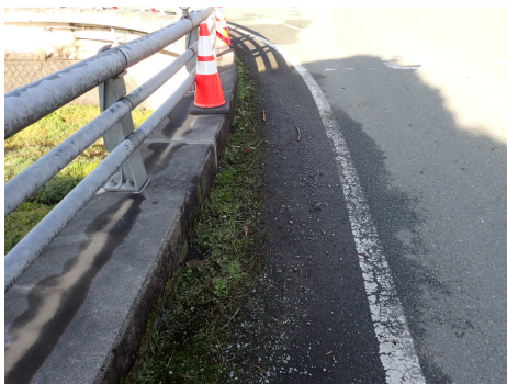
地覆付近の土砂詰まり
