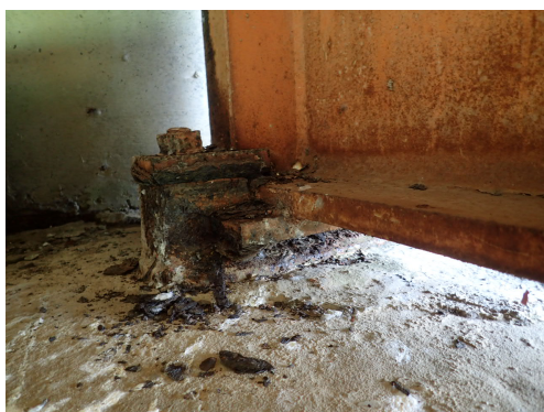
補修前（支承部の腐食）
