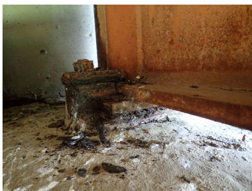
補修前（支承部の腐食）
