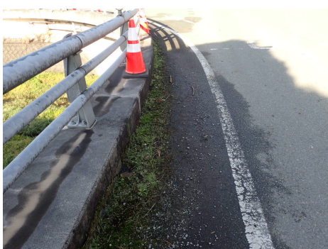
地覆付近の土砂詰まり
