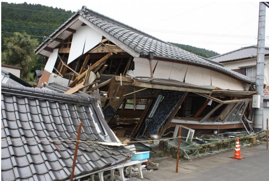
▲本震により全壊した地域のコミュニティ施設(風当集会所)
