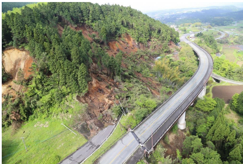
▲大峯山の崩落箇所と現道から 110cm 横ずれした大切畑大橋
