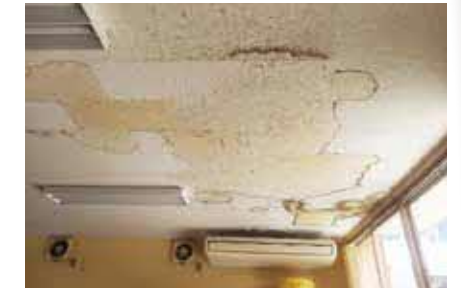
▲雨漏りによるカビ（家庭科室天井）
