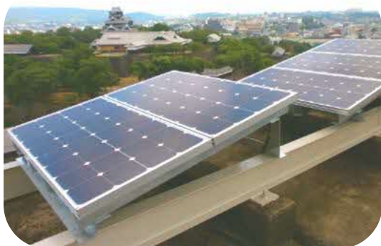
図表 4-1 熊本市役所本庁舎の太陽光発電 (出典：熊本市)
