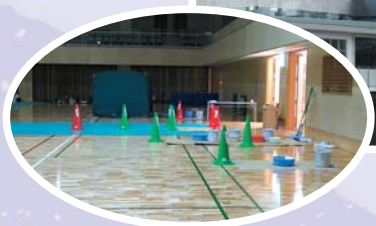
雨漏りにより避難所として一部使用出来なかった総合体育館内部(台風14号接近9月18日夜)
