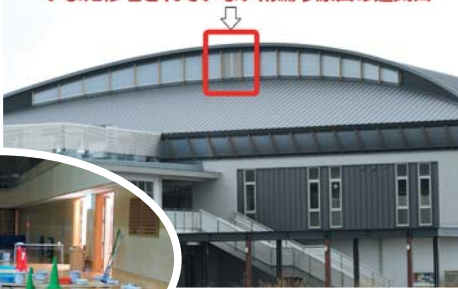
雨漏りした総合体育館
