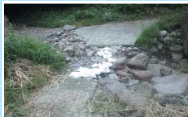
破壊された林道
