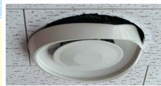
熊本地震で損傷した役場空調設備
