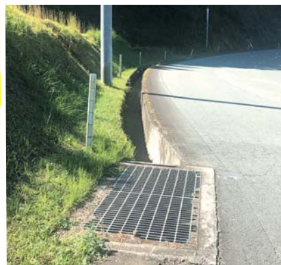
蓋の無い側溝
