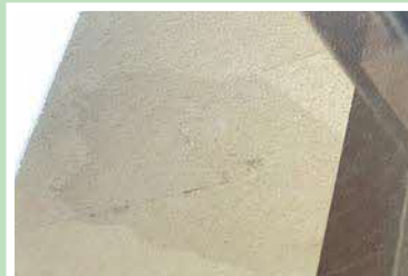
雨漏れが有る校舎の天井
