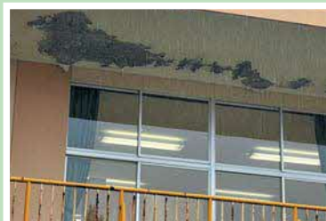
老朽化による校舎の傷み
