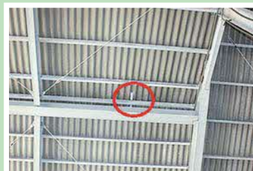
屋根割れ箇所
