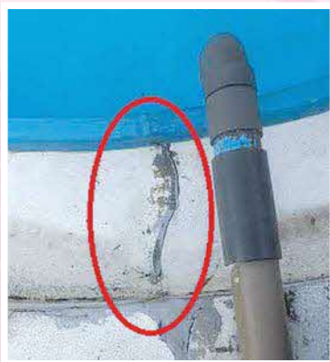
山西小学校プールのひび割れ
