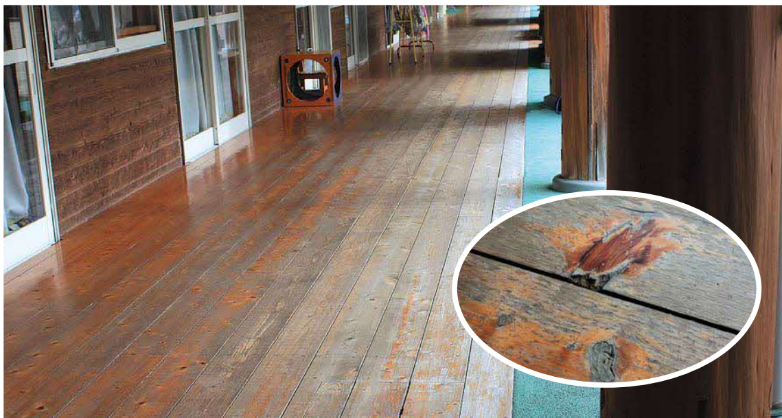
早急の対応が望まれる廊下
