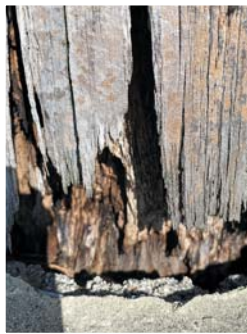
腐食した主柱
